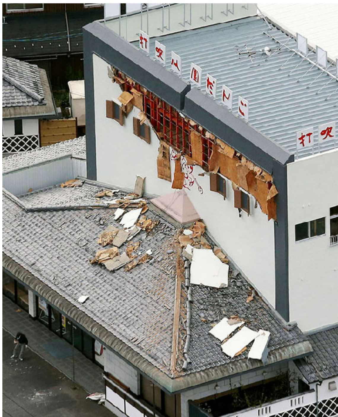
強い地震が起きた鳥取県倉吉市で、外壁の一部が崩落した建物 || 21日午後3時24分 (共同通信社へりから)
